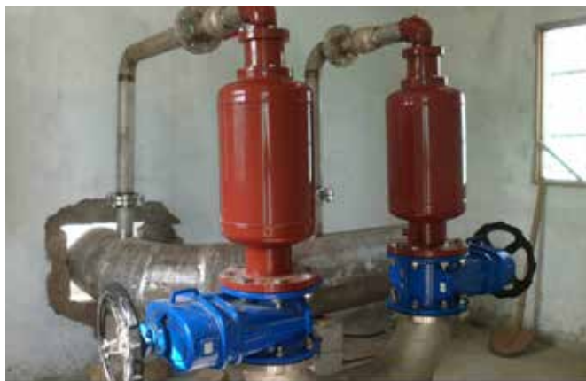
C2D ASSAINISSEMENT_Ventouses de Port-Bouët remplaçant la tour d'équilibre
